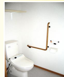
居室内トイレ
